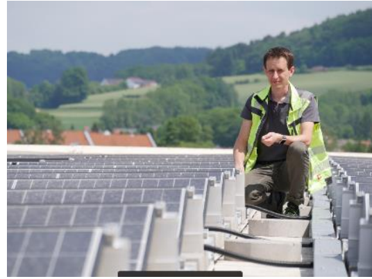
Abb. 4. 7: PV-Anlage auf dem Dach der Mälzerei.
